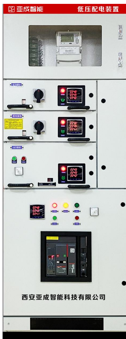
图 1.3 低压配电装置
