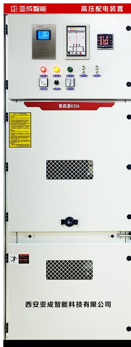
图 1.2 高压配电装置
